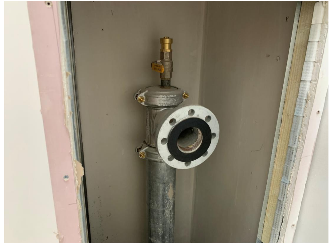
Dry riser stairwell
